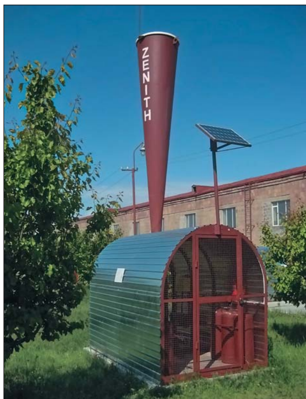
Противоградовая установка для генерации ударной волны.
